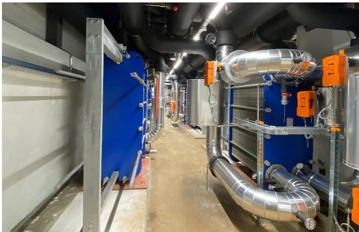
Mit See-Energie investiert ewl in erneuerbare Wärmelösungen. Blick in die See-Energie-Zentrale Inseliqai in Luzern.
