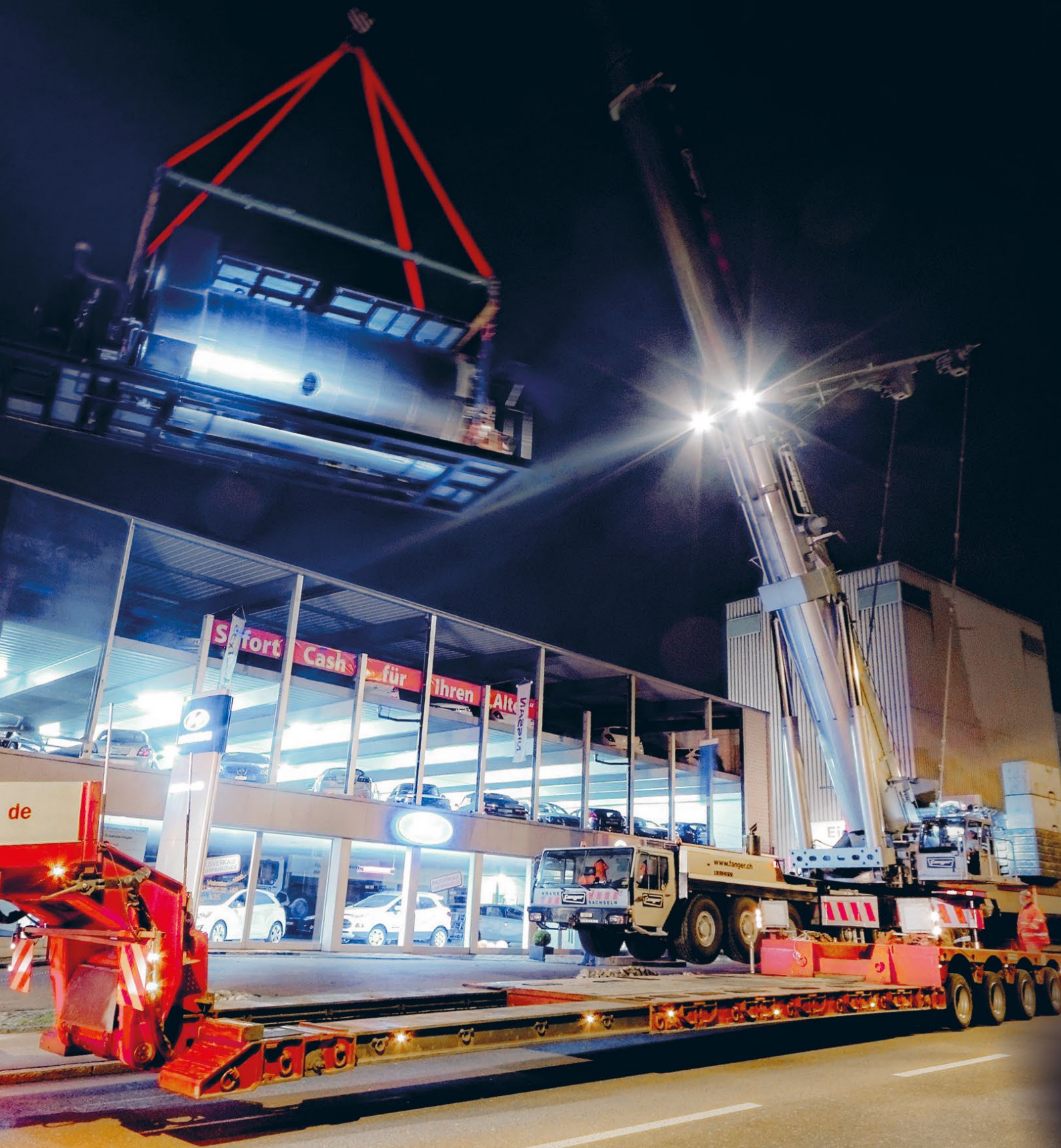
Im Oktober 2014 hievte der Kran zwei 42 Tonnen schwere Heisswasserkessel in das Heizgebäude der KVA Ibach.
