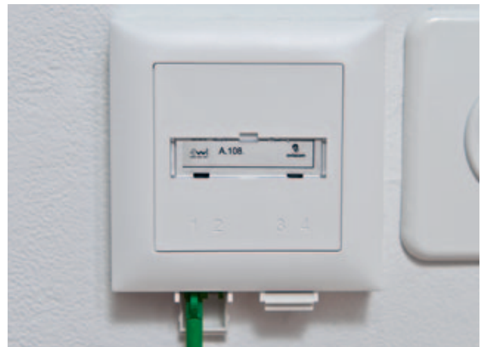
Glasfasersteckdose: Ihr Anschluss an das Netz der Zukunft.
